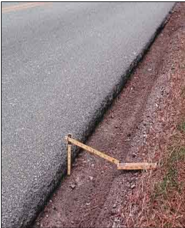
An unsafe pavement edge
